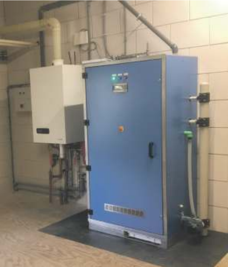
Opstelling van de waterstofgenerator bij de Stichting Woningbouw Achtkarspelen. (foto: Frits Bouwens)
