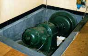
De oude vijzel in het gebouwtje van het gemaal westelijk van de Trekvaart.
